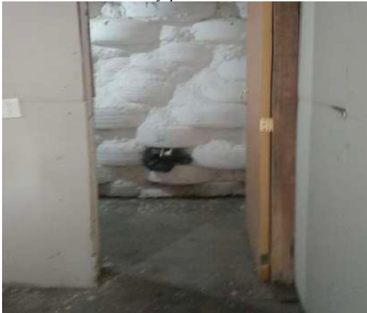
Muros de tabla roca y puertas de madera de la casa ecológica.
